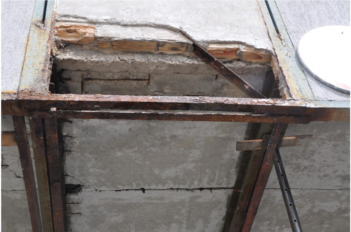
Fot. 5 Skorodowany pas dolny bocznego rygla kratowego nad przejazdem
