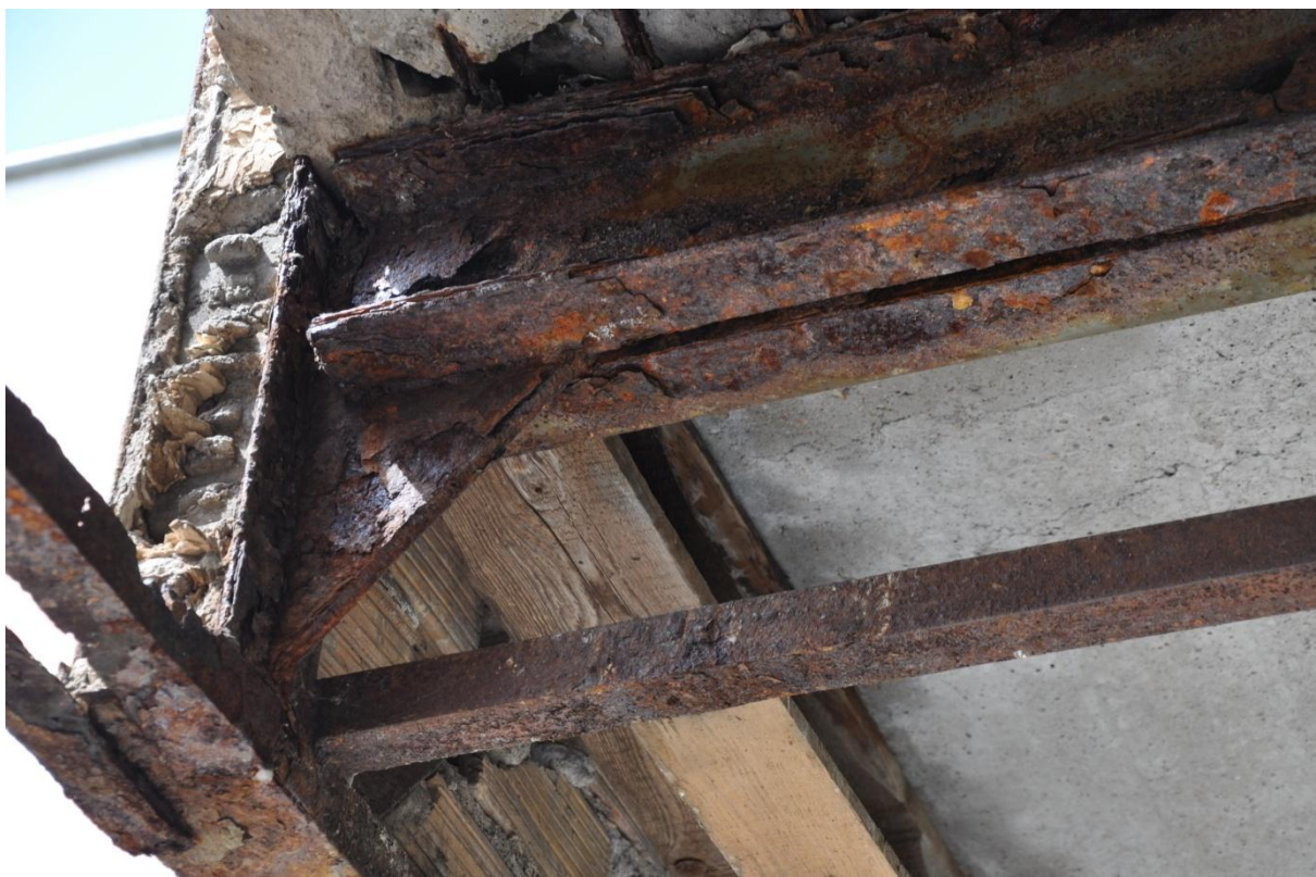
Fot. 1 Korozja strefy podporowej belki stropowej nad przejazdem ( na przecięciu osi f i B)
