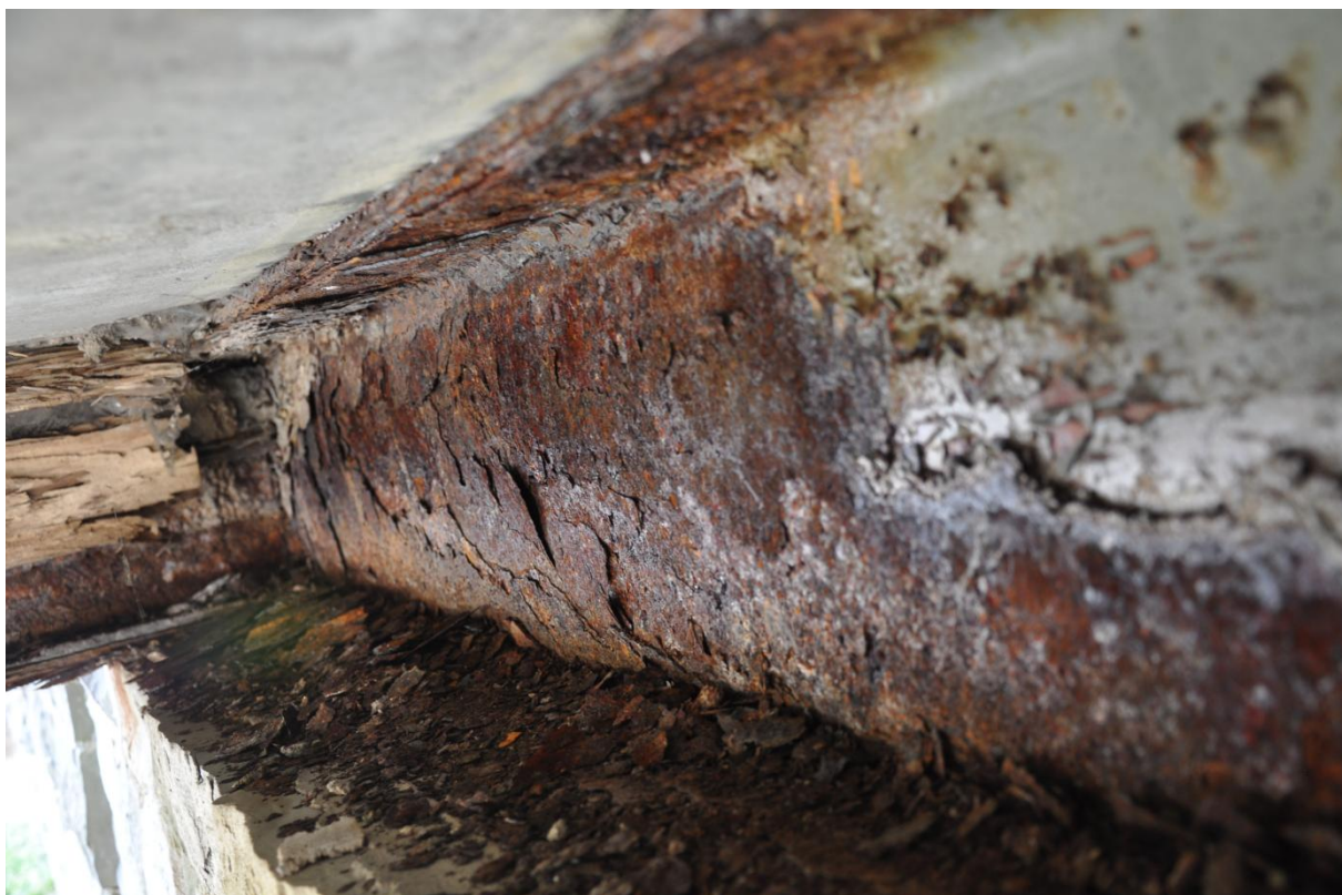
Fot. 3 Perforacja środka belki głównej w osi 3'
