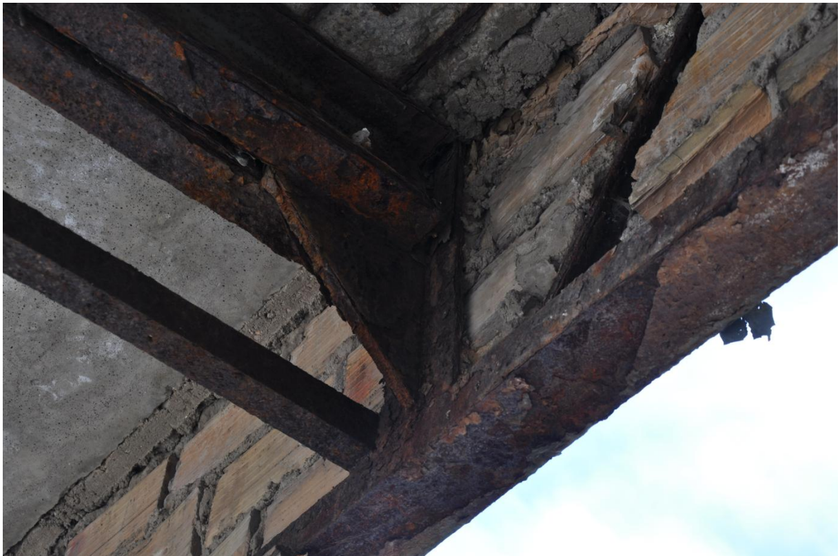
Fot. 6 Korozyja strefy oparcia rygla stropowego na kratownicy bocznej między osiami 1' i 2'
