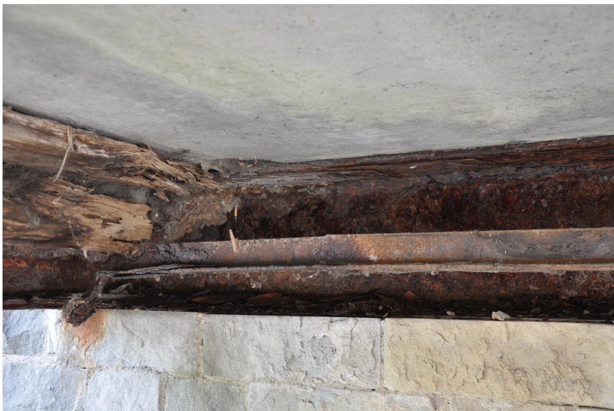
Fot. 4 Korozja strefy oparcia płyt stropowych
