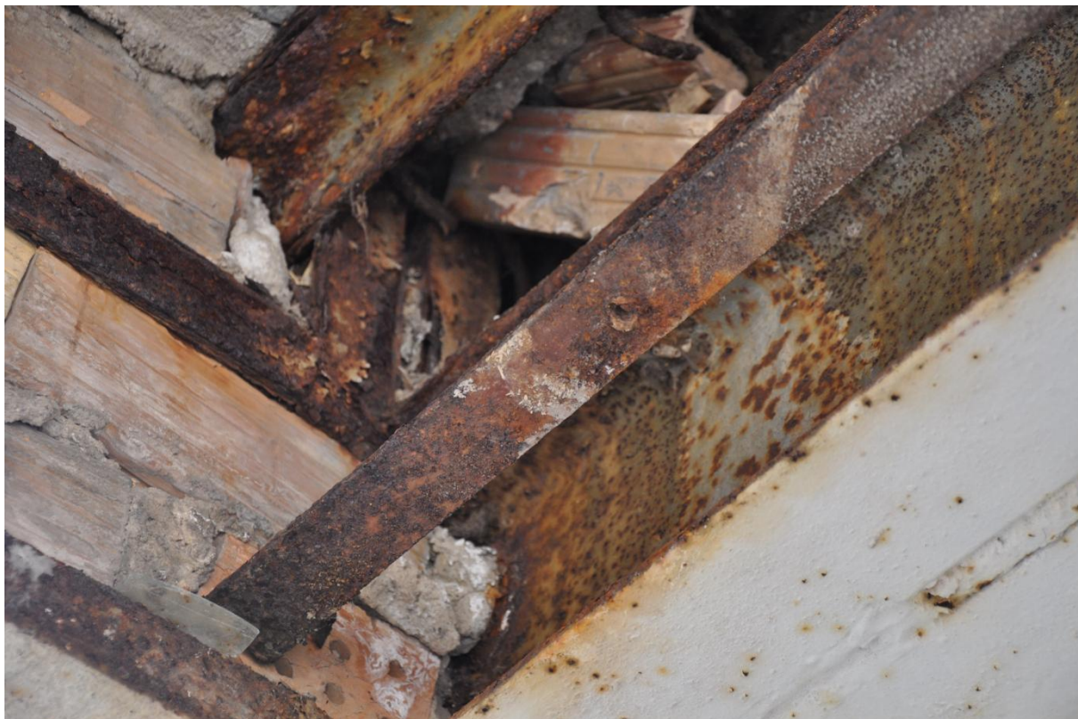
Fot. 2 Korozja rygla głównego w osi 2'
