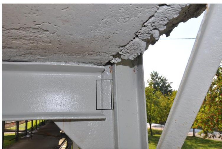
Fot. 6-3 Usytuowanie nakładki wzmacniającej blachy podporowe w osiach od a do i
