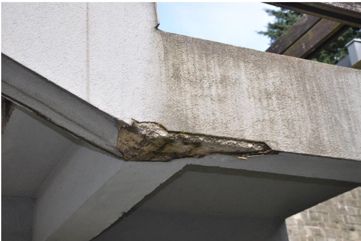
Fot. 8-1 Uszkodzenia okładziny tynkowej
