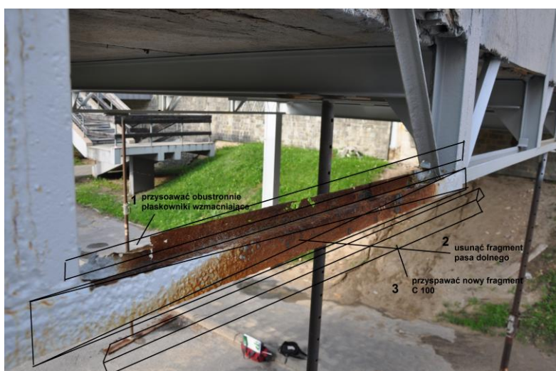
Fot. 6-5 Sposób wymiany uszkodzonego fragmentu pasa dolnego rygla kratowego w osi B
