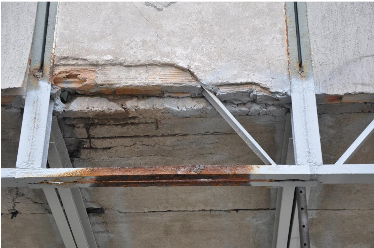
Fot. 7-1 Korozja betonu oraz zbrojenia w strefie oparcia płyt stropowych w osi f
