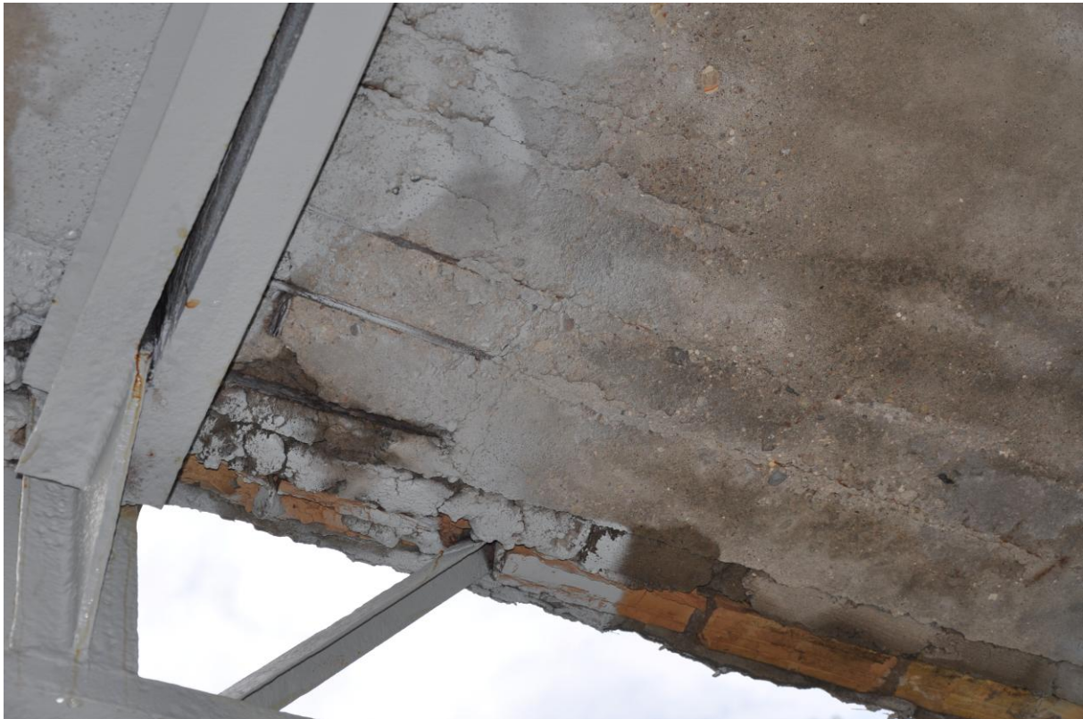
Fot. 7-2 Uszkodzenia płyt stropowych i korozja prętów zbrojeniowych
