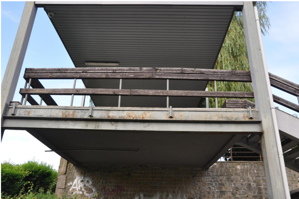
Fot. 8-2 Skorodowane elementy stalowe schodów
